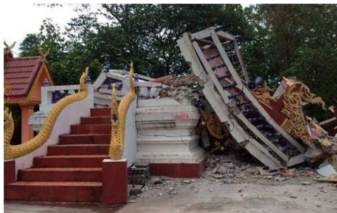
ภาพที่ 8 สภาพเมรุเผาศพ ที่อำเภอพาน จังหวัดเชียงราย พังทลายลงมา หลังเกิดแผ่นดินไหว ที่มา : http://www.oknation.net/blog/hothothot/2014/05/05/entry
